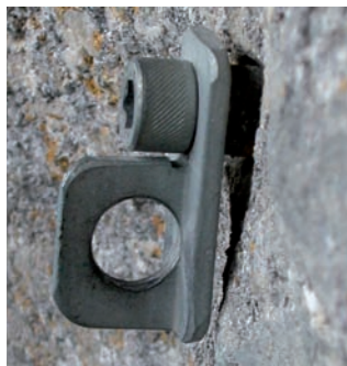
Eine Sanierung ist hier dringend nötig.
