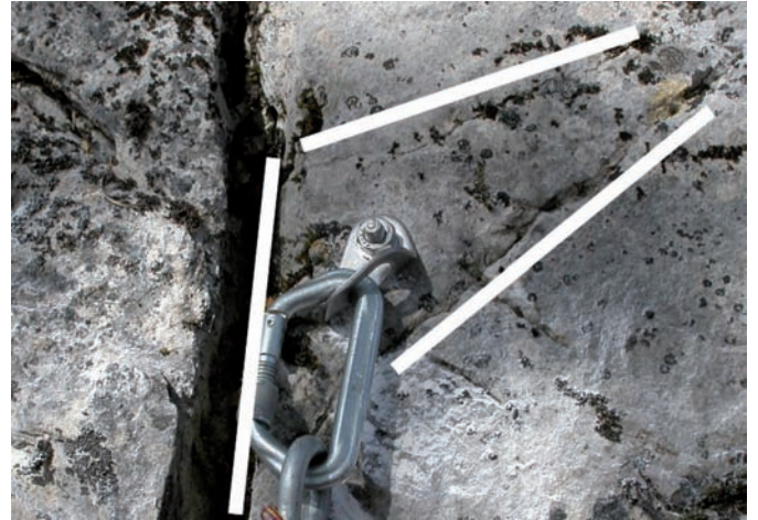
Zu geringer Abstand zum Riss
