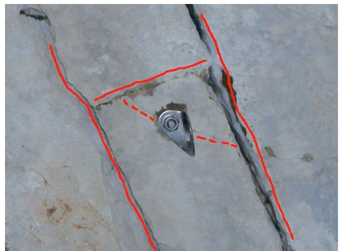
Zu geringe Abstände sowie Risse im Gestein
